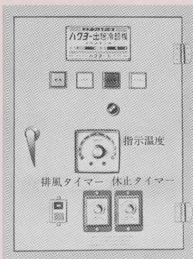
壁掛式配電盤
