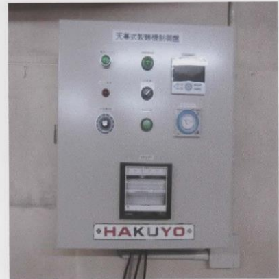
制御盤(記録計付)
