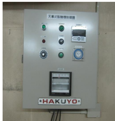
制御盤（記録計付）
